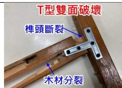
圖 4-19 T 型雙面破壞情況
